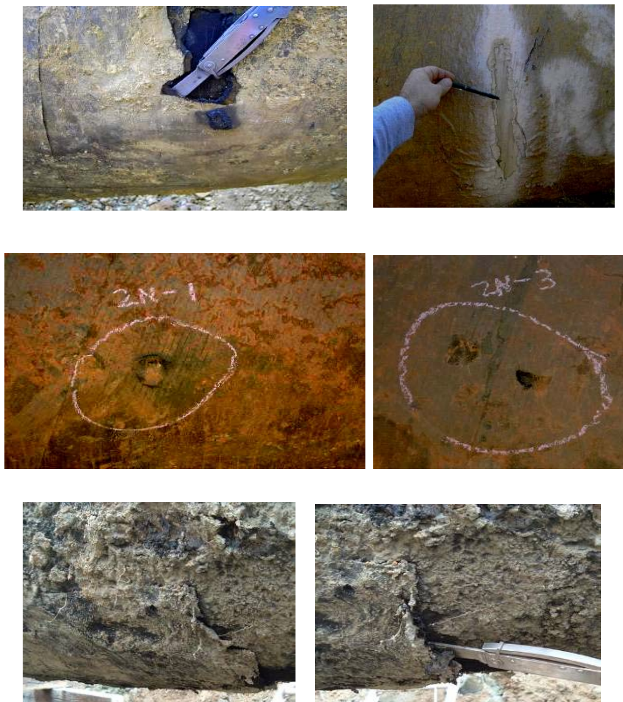
图14：现场1-3,漏点位置的防腐层检查图
